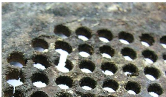
Fig. 20 : matériau de la grille fissuré
